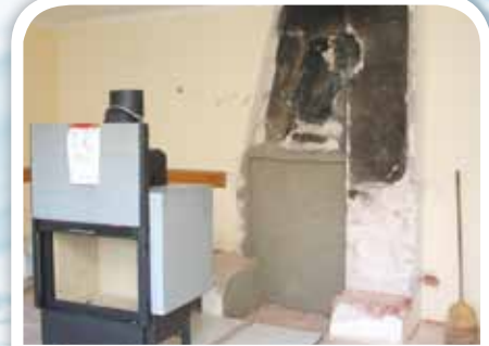
Die Brennzelle steht im Wohnraum.
